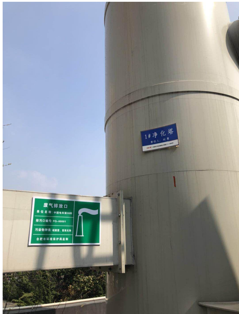
废气排口规范化管理
